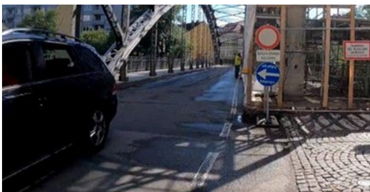
Problematické dopravní značení s nebezpečnou objížd'kou na místě stavebních prací na trase EuroVelo 14 v Rakousku [10]
